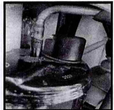
medida del tubo de cobre 3/8" en alta y baja
